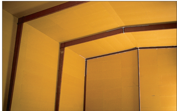
Los tableros MDO se aplican al interior de un edificio refrigerado para almacenamiento.
